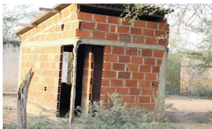
Une fondation financée par l'Union européenne a construit des cahutes souvent inhabitables. CKR
